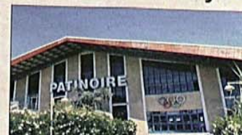
Selon l'expert, les déformations de certaines ossatures « sont anormales et affectent la stabilité et la solidité de l'ouvrage dans son ensemble ».
