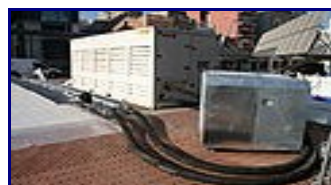
Le groupe de froid, à côté du réservoir tampon, raccordé à la piste de glace
